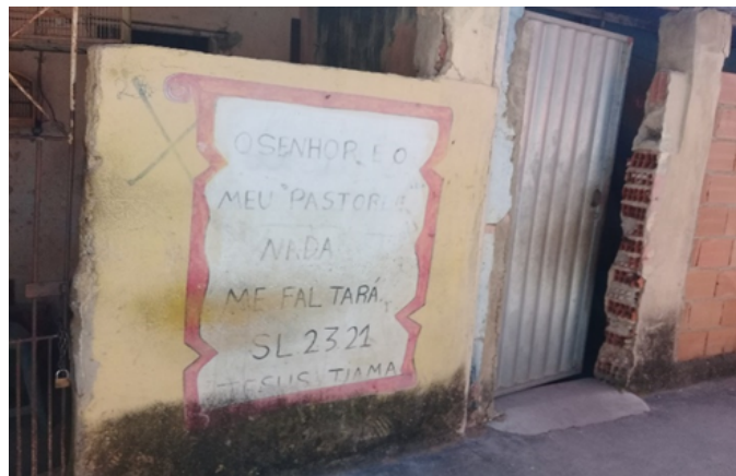
Figura 1: Muro da localidade de moradia de Maria
